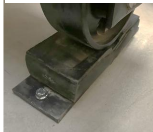
Bild 5-31: Transformator mit Rollen auf Rollenlager
