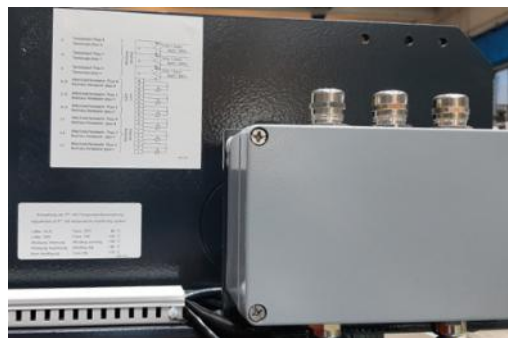
Bild 6-15: Strom-Anschluss für Lüfter (Beispiel)
