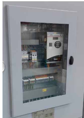
Bild 6-13: Schaltschrank im Gehäuse
