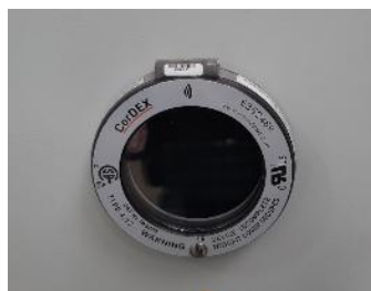
Bild 6-20: Infrarotfenster am Transformatorgehäuse
