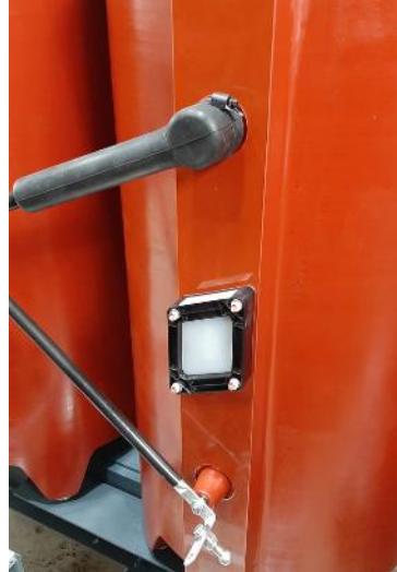
Bild 5-34: Abdeckungen an Schaltrohren und OS-Anzapfungen
