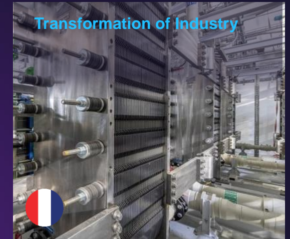
Elektrolyseure für 200 MW-Projekt von Air Liquide in der Normandie
