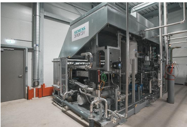
PEM-Elektrolyse von Siemens Energy in der Power-to-Kerosin Anlage in Werlte
