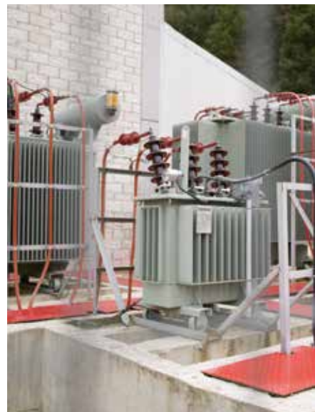
Oljefylt distribusjons transformator
