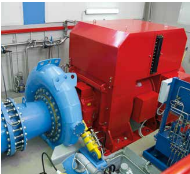
Francis turbin, synkrongenerator og hydraulisk enhet
