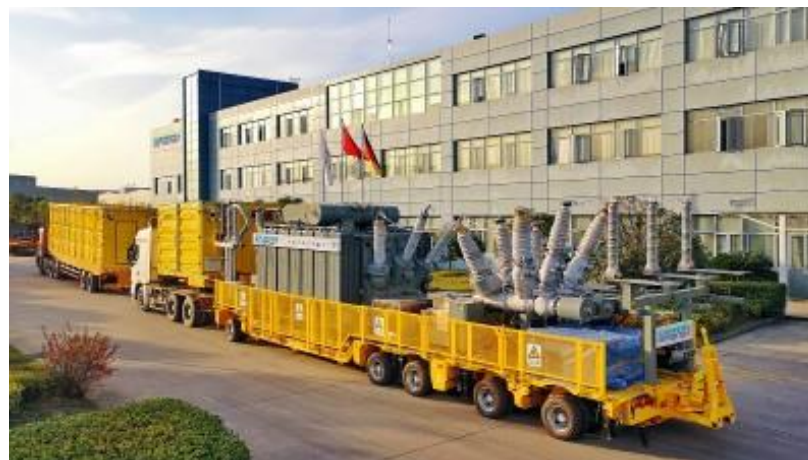
En Zhengzhou: subestación móvil ecológica equipada con un Sensformer™, lista para funcionar.
